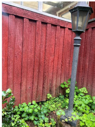
Bytes behov av viss fasad/panel.
