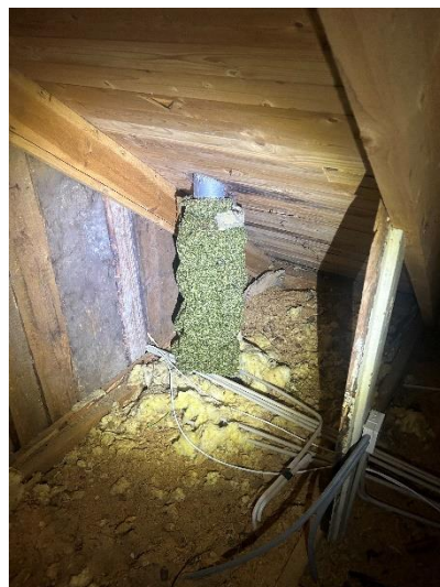
Im-kanalen saknar godkänd brandisolering.
